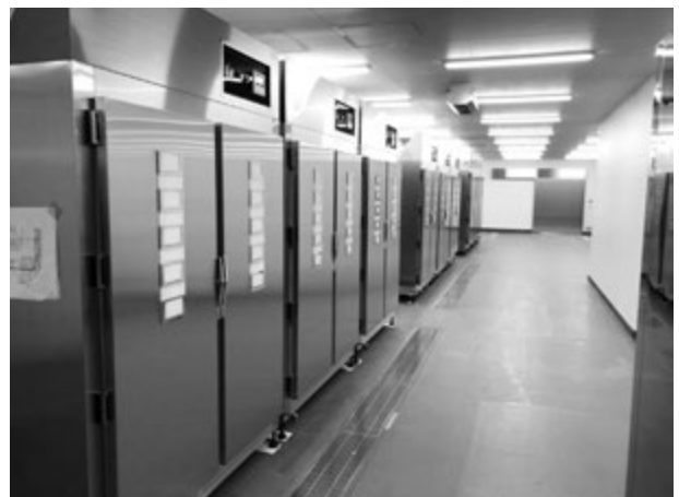
図4 手前が冷蔵庫、奥が冷凍庫
